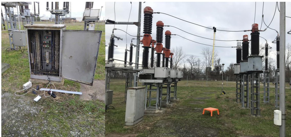
Slika 8. Fotografije sa ispitivanja sistema u postrojenju TS 110 kV/20 kV.
